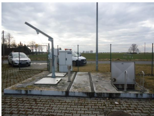
Рис.6 Канализационная насосная станция
